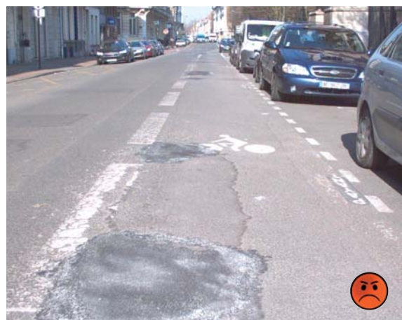
Revêtement dégradé pénalisant la circulation du cycliste
